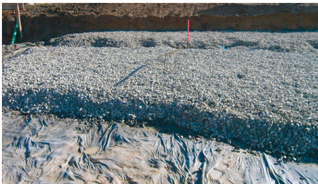
Abb. 33: Ein Splittbett als Sauberkeitsschicht und Nivellierebene sorgt für einen ebenen Unterbau. Diese Tragschicht wird gemäß den Anforderungen an den Baugrund und den Angaben des Statikers aufgeschüttet und verdichtet.
