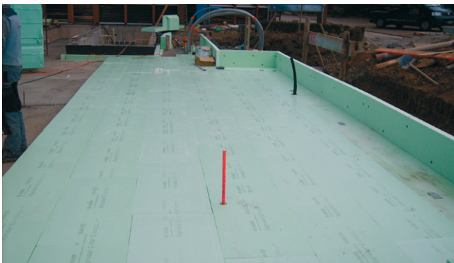
Abb. 38: Die Styrodur-Platten mit allseitigem Stufenfalz werden in der ersten Dämmlage im schleppenden Verband verlegt. Der Verlegebeginn und die Verlegerichtung erfolgt objektbezogen und individuell nach gefertigten Montageplänen.
