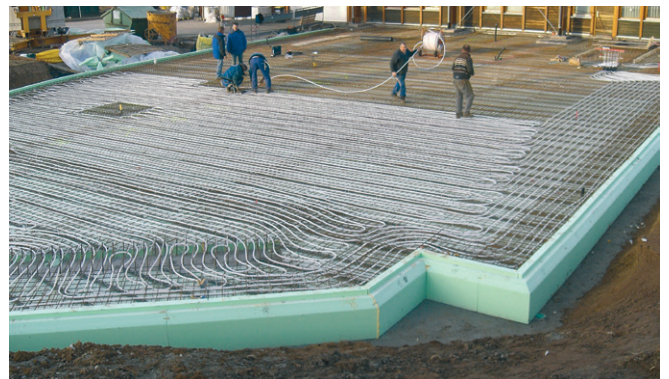
Abb. 41: Die thermisch aktivierte Bodenplatte dient als großflächiger Wärmespeicher und führt zu Energieeinsparungen von bis zu 30 Prozent. Die Reduzierung des Fußbodenaufbaus sorgt zusätzlich für einen Raumhöhengewinn.
