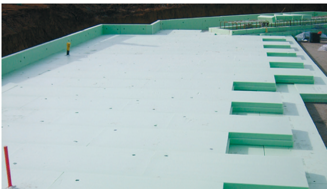
Abb. 39: Die zweite Dämmlage, ebenfalls aus Styrodur-Platten mit allseitigem Stufenfalz, wird fugenversetzt zur ersten Plattenlage eingebaut – ebenfalls im schleppenden Verband.
